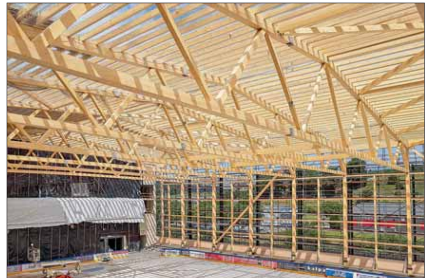
Für die Eishalle Pruntrut (Schweiz) wurden die Stützen aus „Stabbuche“, das Dach aus Esche und Nadelholz konstruiert. Foto: Fagus Suisse, le Breuleux
